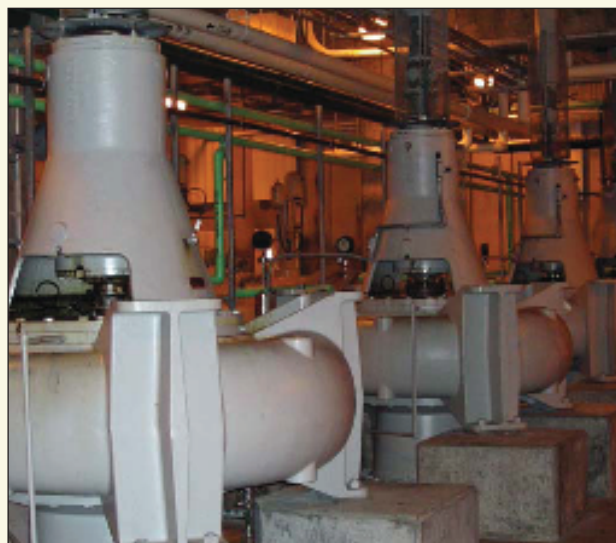
Le pompe di scarico , con tenute split di 200 mm di diametro, sono in servizio da oltre 12 anni.
